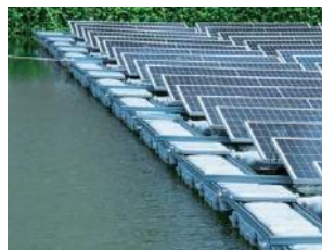
水上漂浮电站
