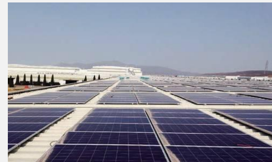
高邮市航天锂电光伏 6MW+10MW/20MWH储能项目
